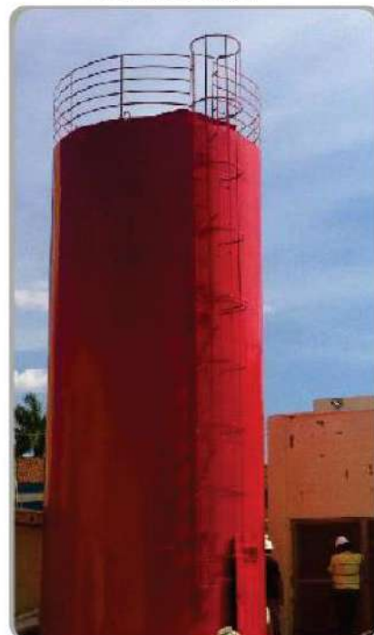
Reservatório Tubular com Casa Maquinas
