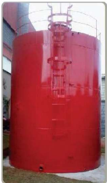
Reservatório Apoiado para combate incêndio
