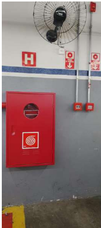
Instalações de hidrantes.
