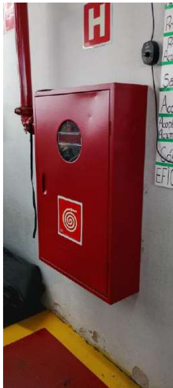
Instalações de hidrantes.
