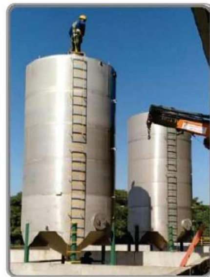
Reservatório em Inox
